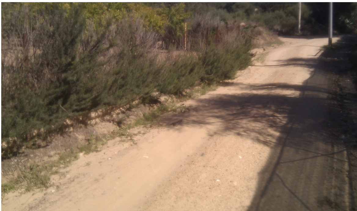
Figura 1. (F1) Zona nella quale è evidente il dissesto della strada, causato dallo scadente sottofondo, soggetto a cedimenti, della pavimentazione facilmente dilavabile e dalla pendenza. Si noti l'assenza di cunette.
