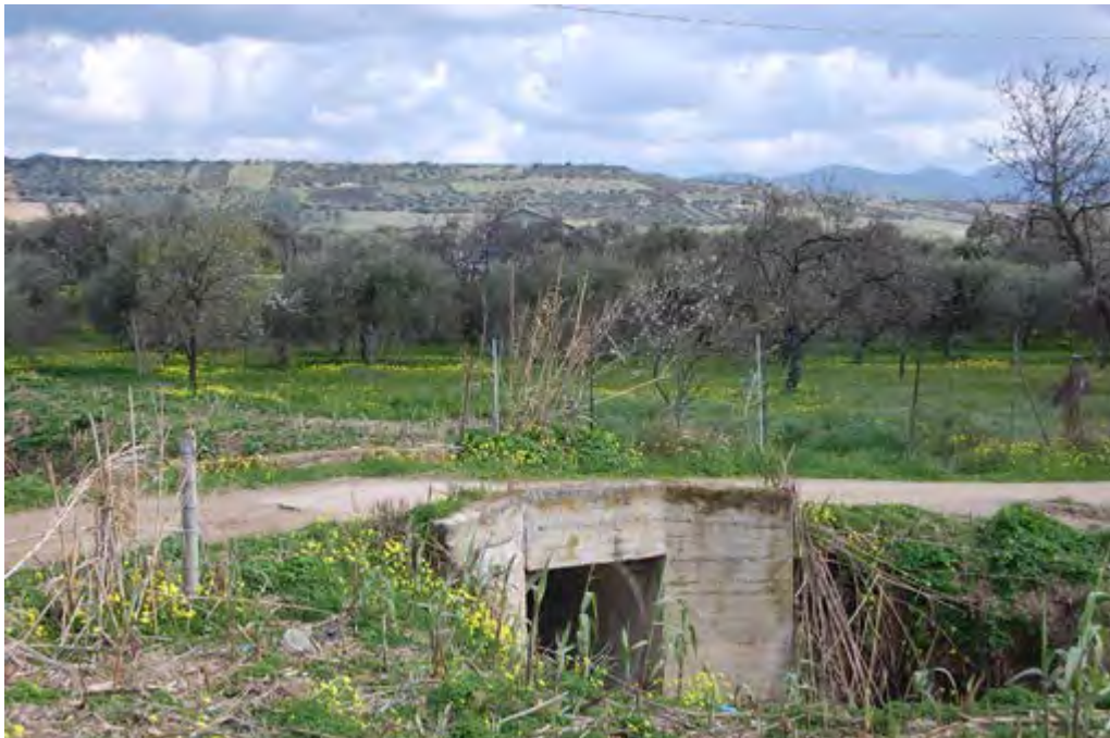
Foto 8. Tratto T2a: vista dello stato di attuale dei luoghi. Del ponte di attraversamento del Rio Foxi (o Rio Tanieli) Punto di ripresa F8 indicato nella Tav.6.
